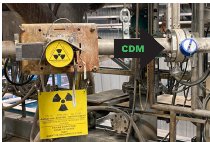
Le CDM installé sur la même ligne où le densimètre basé sur le rayonnement mesure la densité
